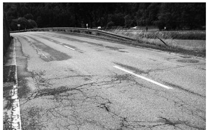
Die B32 im Laucherttal weist an manchen Abschnitten recht üble Straßenschäden auf. Foto: Landratsamt Sigmaringen
